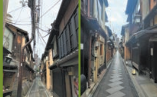
京都市先斗町の無電柱化工事前（左）と工事後（右）。レジンコンクリート製電線共同溝が「重機が入らない狭い場所」、「深夜のみの限られた時間の中で」の施工を可能とした。
